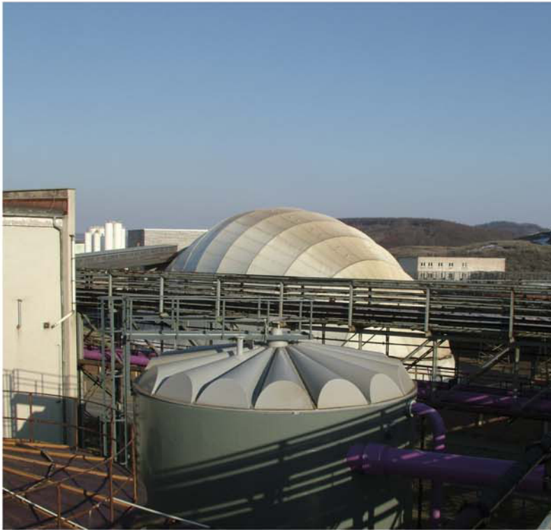
Abdeckung eines Tankes Tank covering
