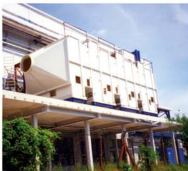
Nasswäscher aus GFK Wet scrubber (IWS)
